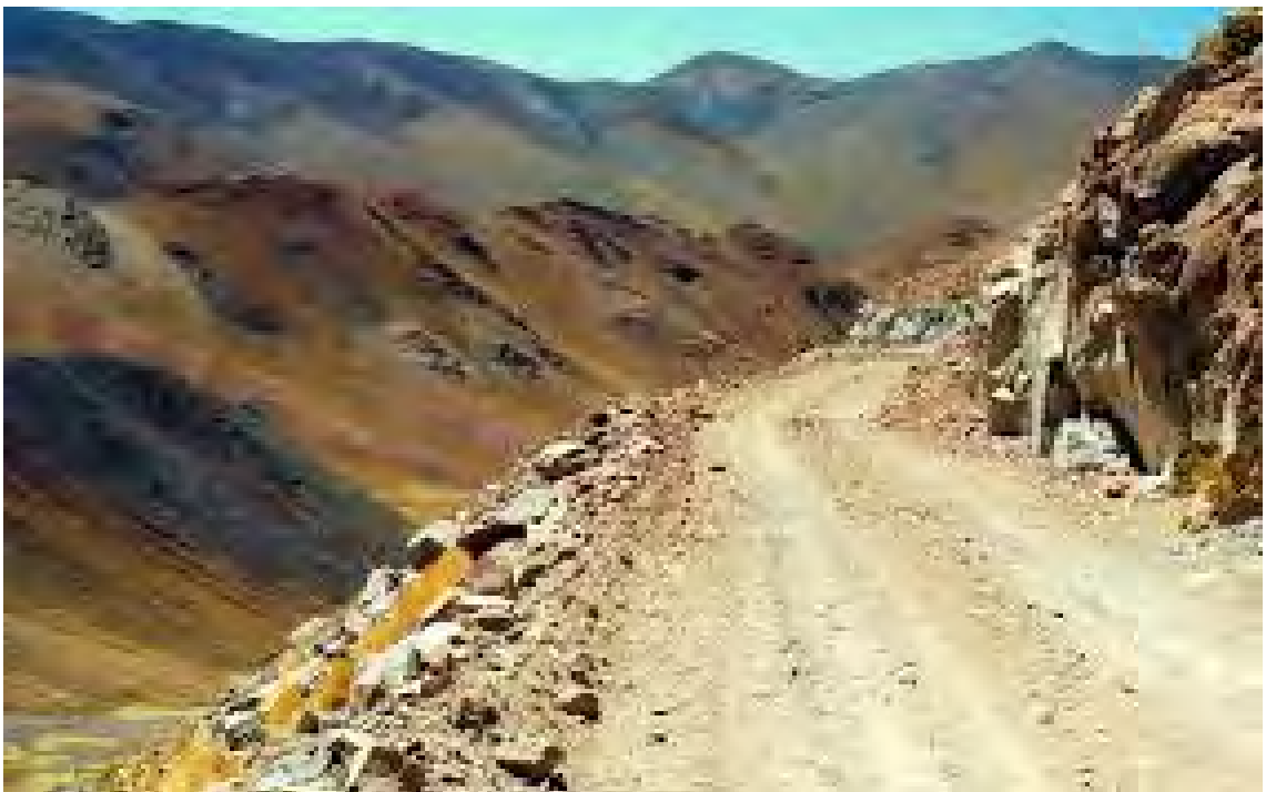
(Vista de un tramo del camino entre el volcán y Valle del Tania)
